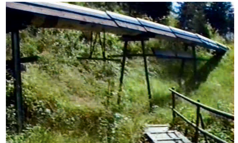
Leitungsführung durch das unruhige Berggelände zwischen Tintelsbach und Rosalisweiher, 1992
